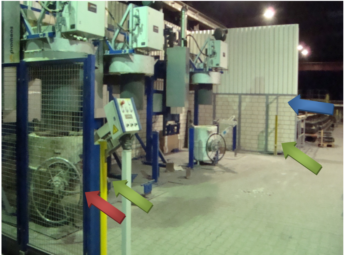
Abbildung 25: Sicherheitseinrichtungen der Pfannenaufheizstation
