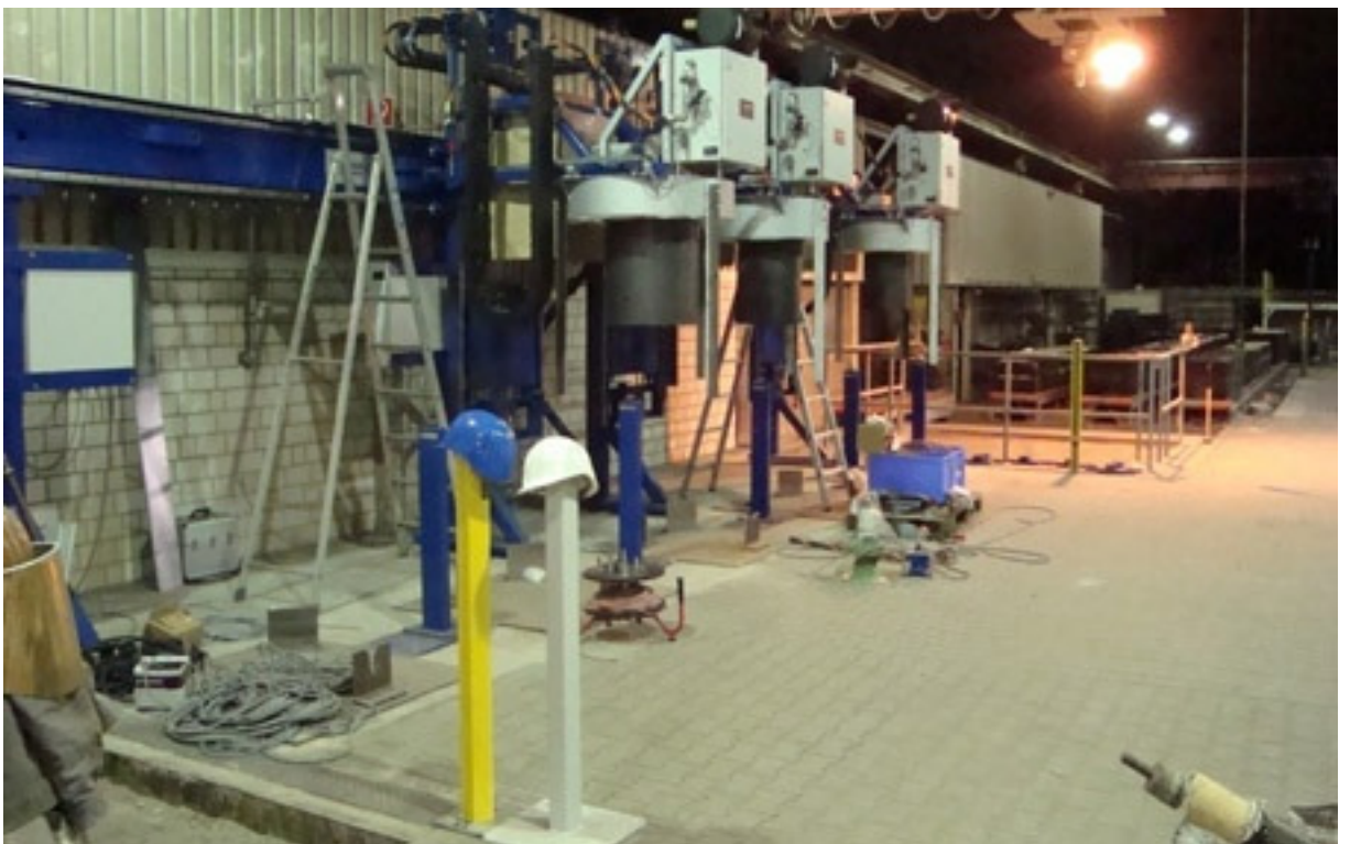
Abbildung 19: Verdrahtung der Anlage
