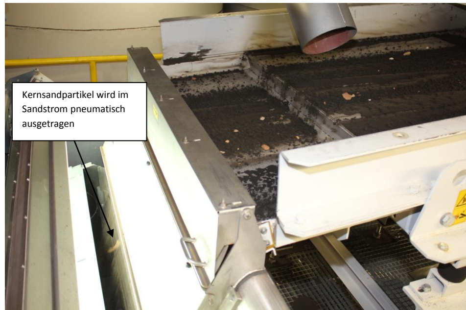
Bild 2.6b: MicroSort-Anlage: Blick in das geöffnete Aggregat
