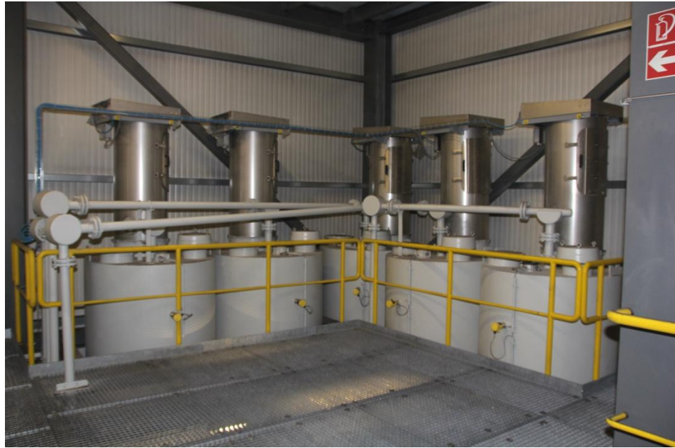
Bild 2.8: Additivbunker für die Zugabe von 3 x Neusand, Filterstaub und Bentonit
