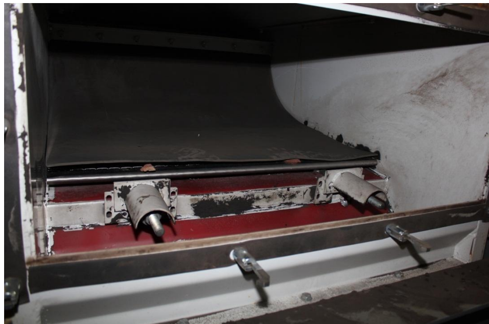
Bild 2.6 b: Flachsieb #2: Blick in das geöffnete Aggregat Deutlich erkennbar sind die enthaltenen hellen Kernsandreste, die an dieser Stelle endgültig ausgeschleust werden
