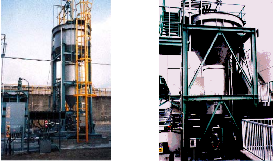
Abbildung 5: Phosphor-Rückgewinnung (Struvit) im Betriebsmaßstab aus industriellem Abwasser der KA Shimane, Japan. (48 m 3 /Tag); konstruiert von Unitika Ltd, Osaka, im Betrieb seit 1995 [8].
