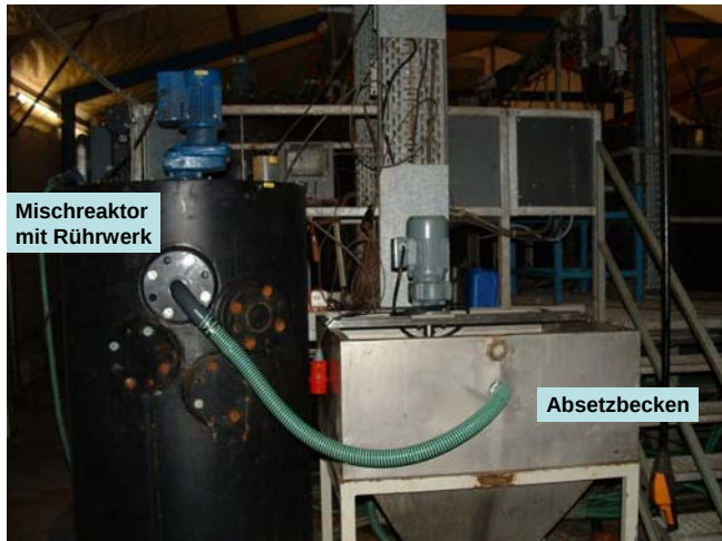
Bild 8.38: Mischreaktor mit Rührwerk und Absetzbecken der Nachfällungseinheit
