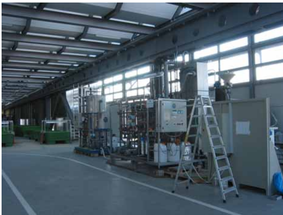
Abb. 32: Pilot-Mikrofiltrationsanlage in der FSA-Halle (Quelle: Autoren)
