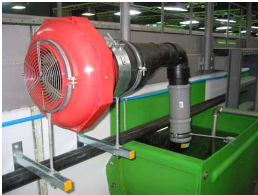
Abb. 81: Ventilator mit Ausströmöffnung über der Wasseroberfläche des Teiches (Quelle: Autoren)
