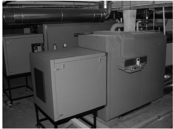
Abbildung 11: Die neue Gasheizungsanlage am Bismarckplatz
