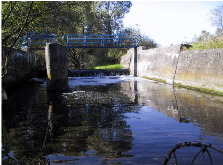
Fotografia 4: Odberný objekt vodná nádrž Miková
