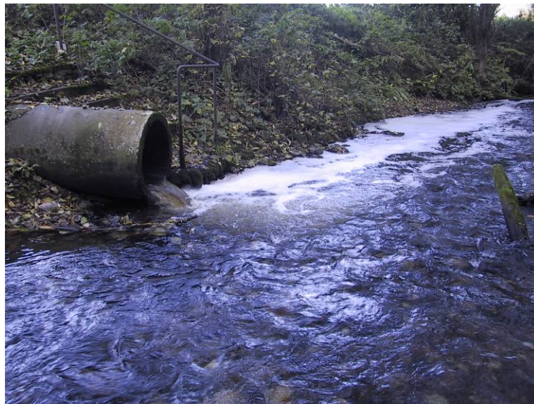
Fotografia 3: Vyústenie odpadu ČOV Revúca
