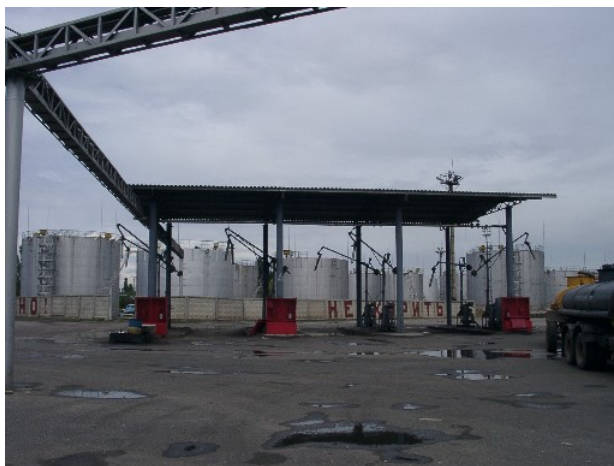
Abbildung 1: Tankwagenabfüllung und im Hintergrund Lagertanks ohne wirksamen Auffangraum
