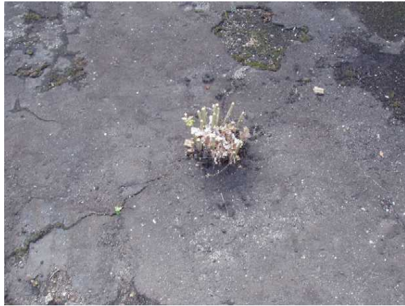
Abbildung 20: Zerstörte Dichtfläche durch Pflanzen
