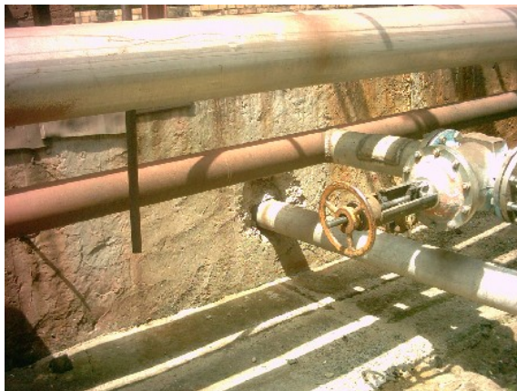
Abbildung 9: Rohrdurchführung im Auffangwannenbereich
