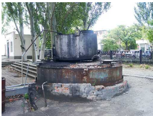
Abbildung 18: Tank für ein Gemisch aus Diesel und Altöl
