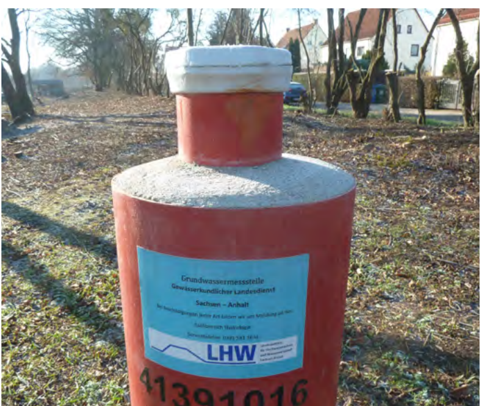
Grundwassermessstelle in Dessau-Roßlau Bild: Umweltbundesamt
