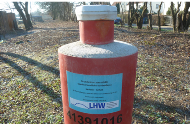
Grundwassermessstelle in Dessau-Roßlau Bild: Umweltbundesamt
