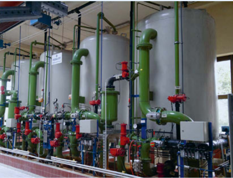
▲ Aufbereitungs- anlage im UBA-Betriebs- wasserwerk (biologisch arbeitend, zweistufig)
