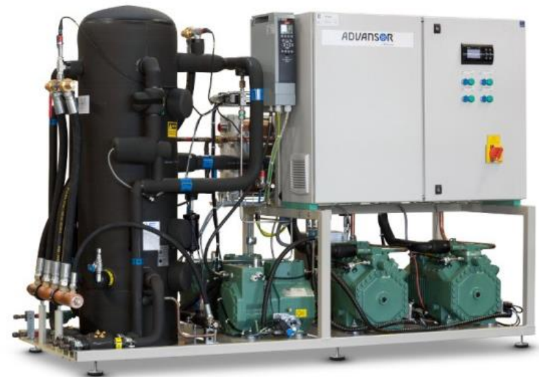
80+20 kW mit CO 2 NK und TK, zwei Verdampfungstemperaturen Max 5 Verdichter pro Verbund
