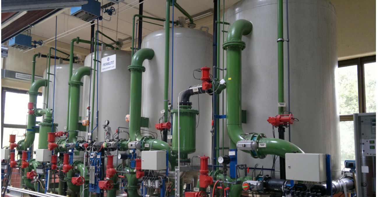
Aufbereitungsanlage im Betriebswasserwerk (biologisch arbeitend, zweistufig)
