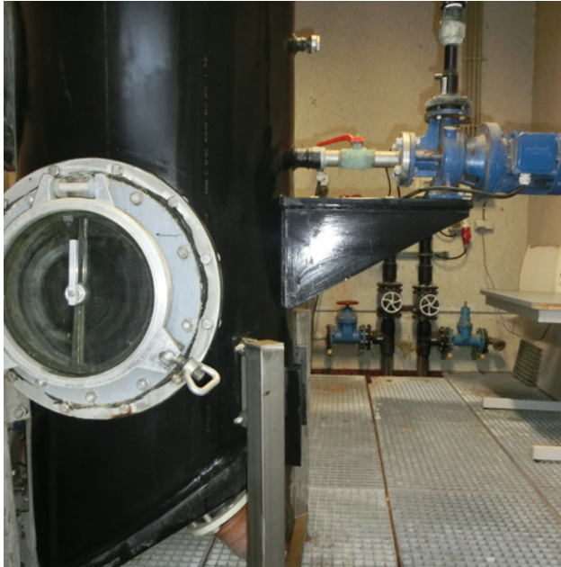
Anschluss zur Gewinnung von Rohabwasser
