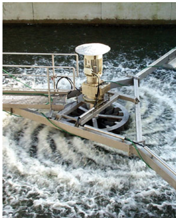
Anhang 5, Abb. 14: Crown Oberflächenbelüfter der SBR-Anlage (System BIOGEST)
