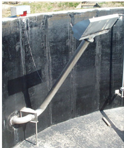
Anhang 5, Abb. 16: Abflussregler SBR Anlage (System BIOGEST)
